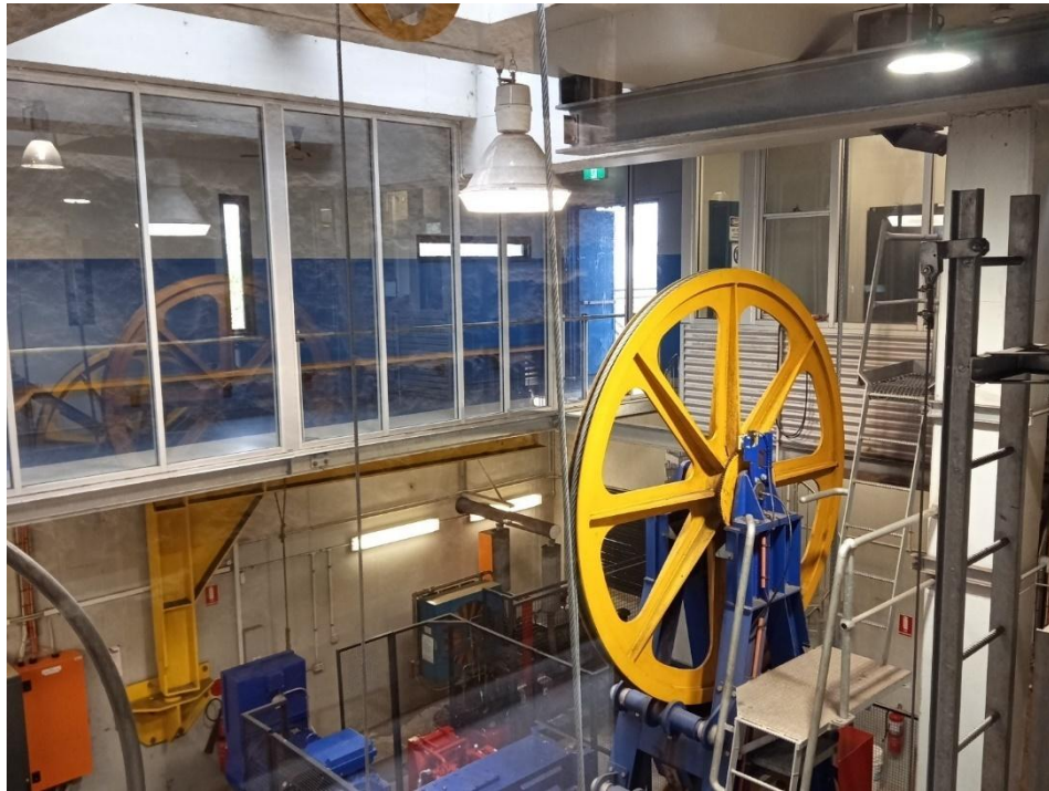
圖 2.1-32 Scenic Cableway 機房
