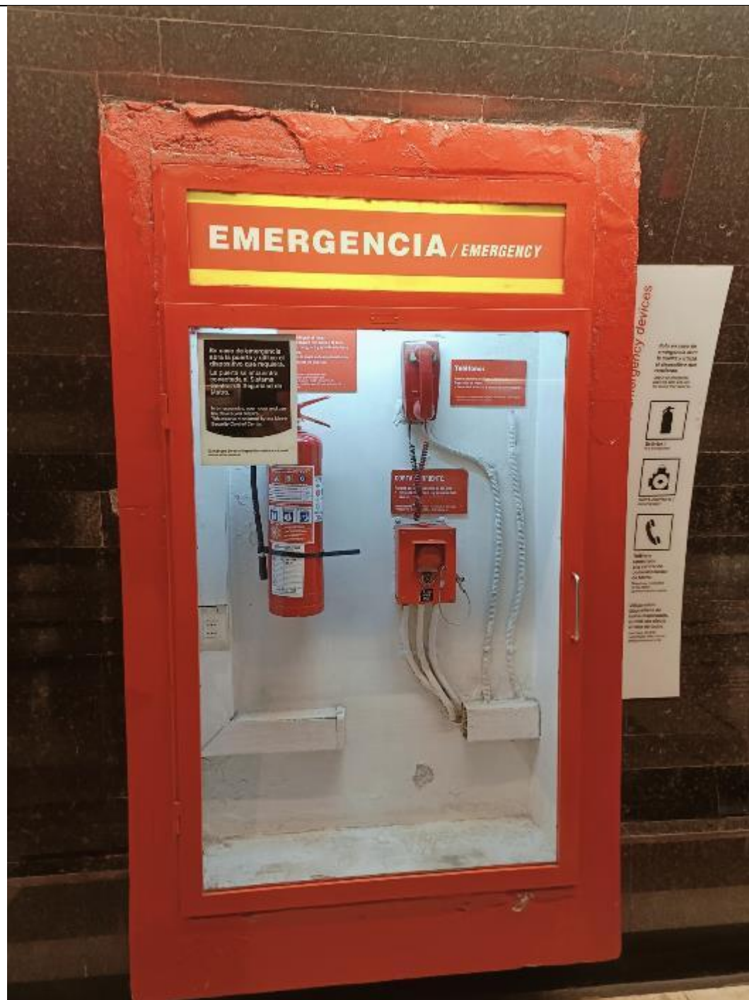
圖 45 智利聖地牙哥捷運 4 號線月台層緊急設施
