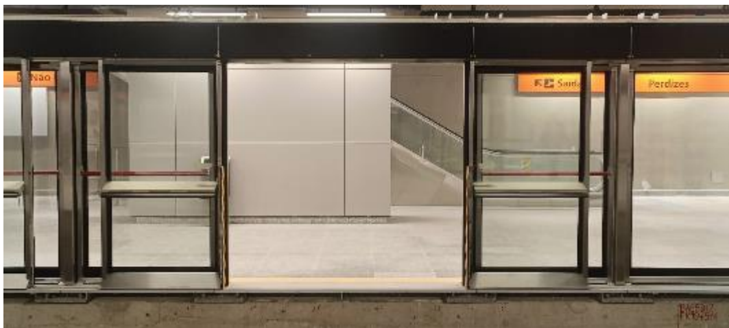
圖 110 聖保羅 6 號線地下車站試營運期間月台門未關閉
