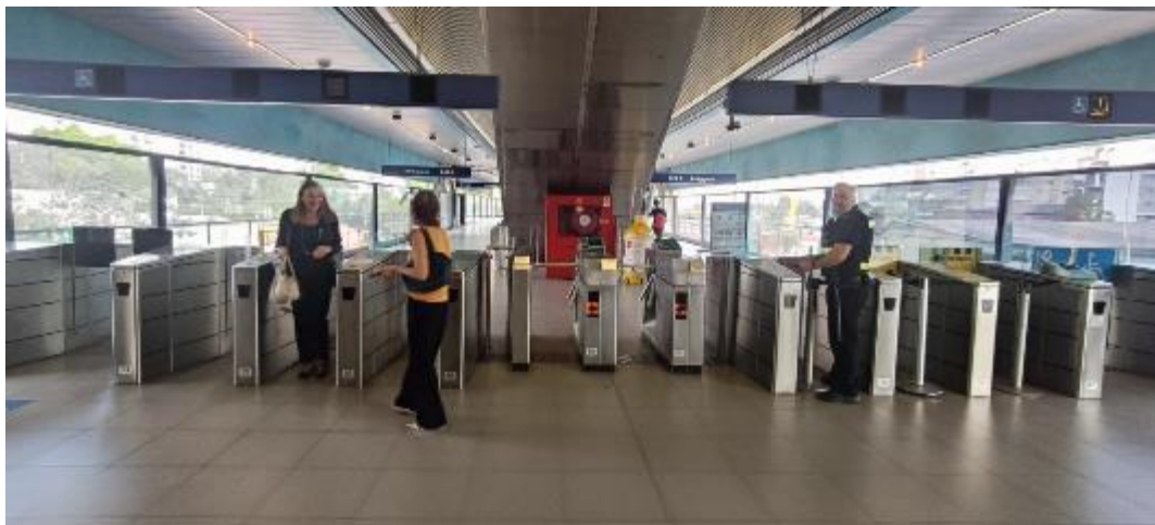
圖 105 聖保羅 15 號線自動收費閘門
