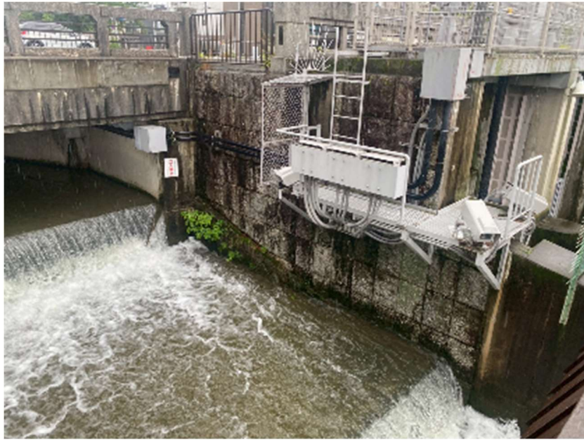
圖 3.17 琵琶湖疏水道與鴨川匯流處之水情監測設施
