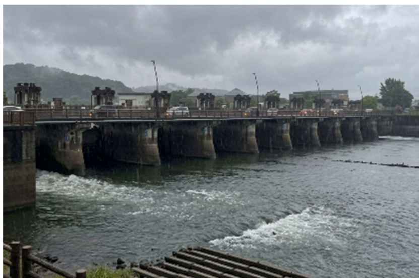
圖 3.18 瀨田川洗堰電動水門設施用以調節瀨田川流量
