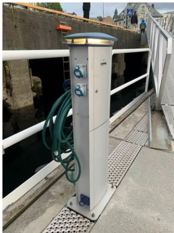
圖 13 奧勒松港區的岸電系統
