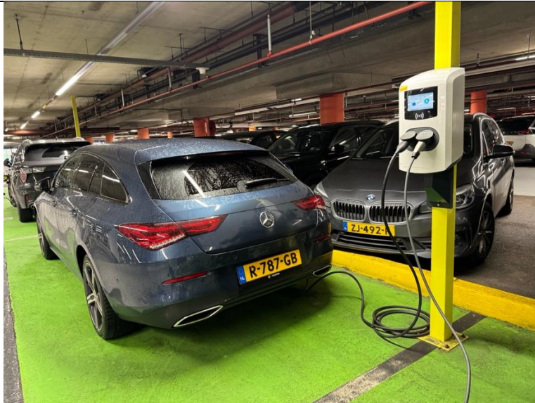
圖2.3.13 RAI 展覽中心地下停車場水平充電格位
