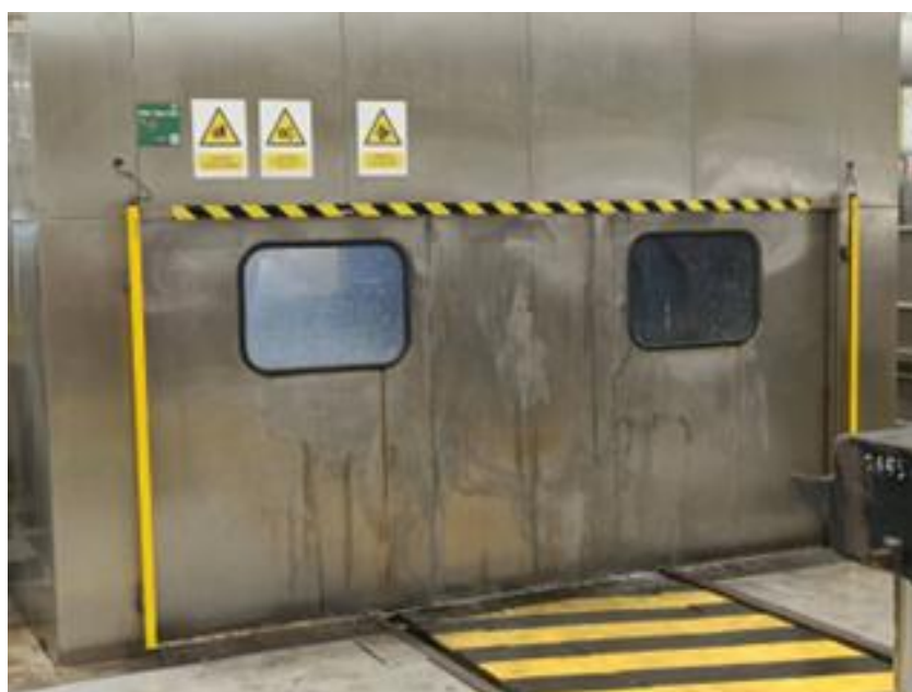
圖 11 碧山機廠轉向架自動清洗設備
