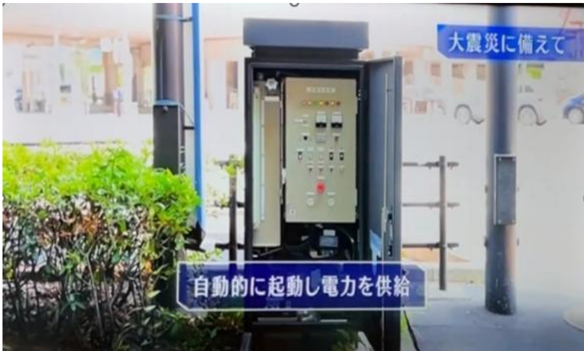
圖2.1.10 號誌控制器內設置不斷電設備
