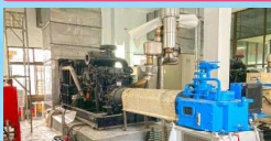
長元站更新2組抽水機組
