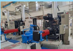
永和站更新3組抽水機組
