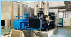
江子翠站更新4組抽水機組
