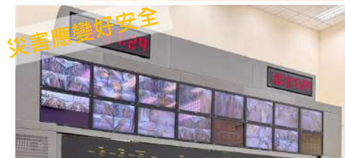
監視器連動乘客緊急對講機
