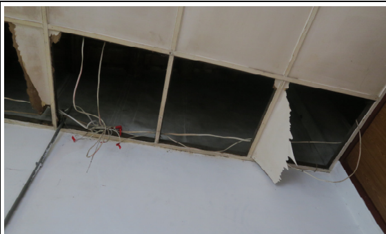
鶯歌區陶瓷段重建前建物內部老舊斑駁
